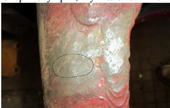
Рис. 5. Поверхнева тріщина в конструктивному елементі бокової рами
